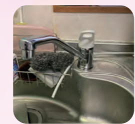
【2024年1月】かあさんの家・曾師の台所の水栓が壊れてしまい新しく付け替えました。
